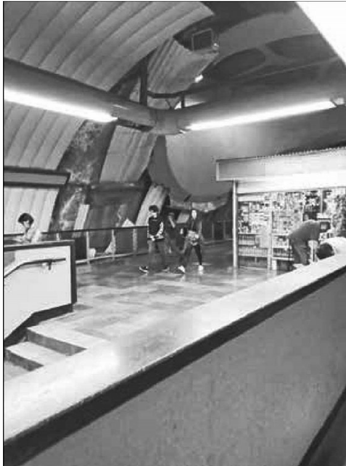
▲ En las instalaciones de la estación Tacubaya del Metro los usuarios transitan entre charcos de agua y parches en plafones y paredes. Fotos Nayeli Ramírez Bautista
