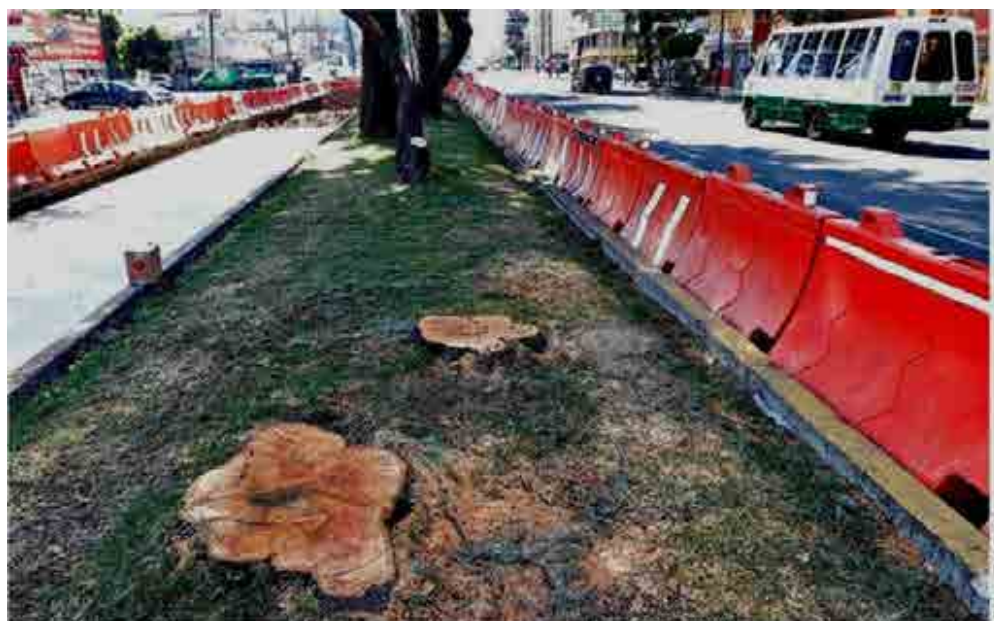
■ Sobre Avenida Cafetales, entre los carriles confinados para la Línea 3, quedaron los tocones.
