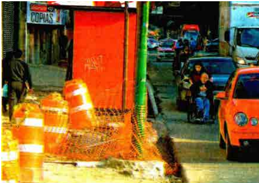
A personas en silla de ruedas nos les queda más remedio que pasar entre los automóviles y el acordonamiento de las obras /FOTO: LUIS A. BARRERA
