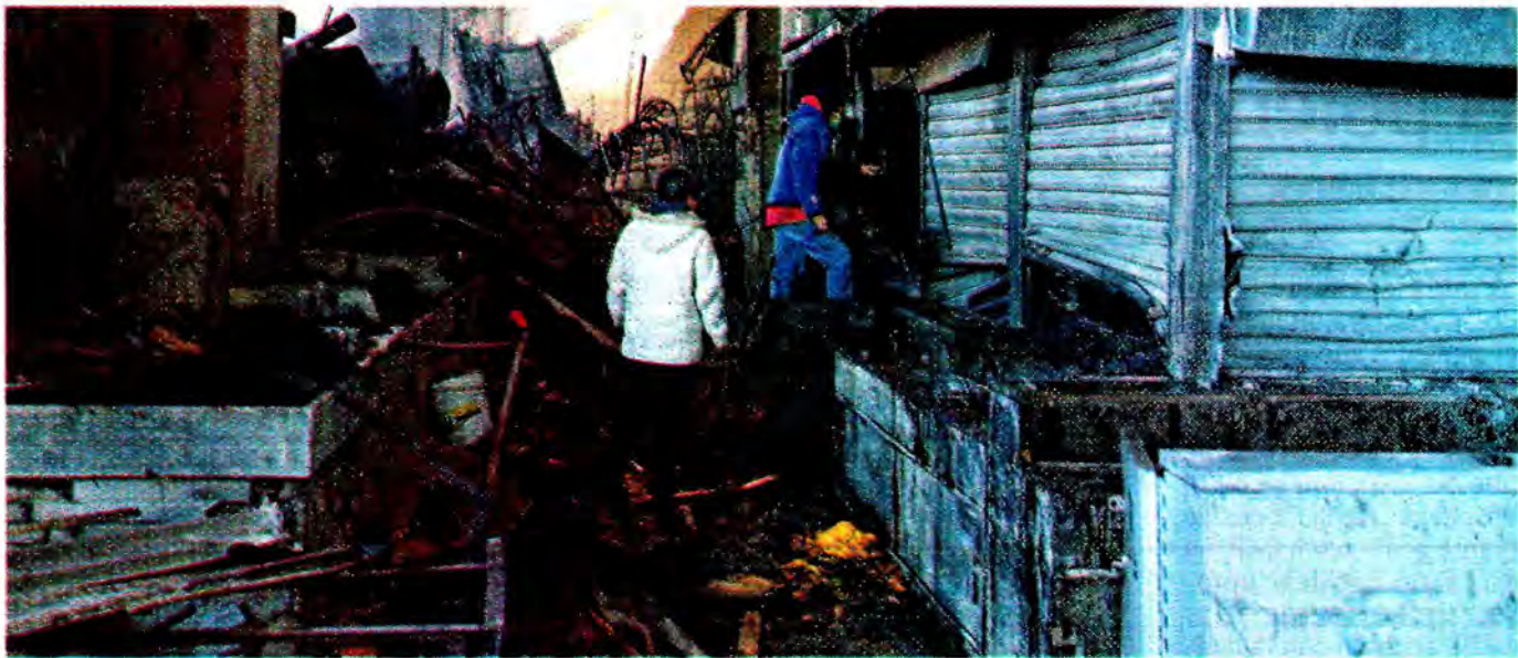
Tras el incendio, locatarios de la Nave Mayor acudieron a sus locales para revisar los daños y más tarde tratar de limpiar los escombros.
