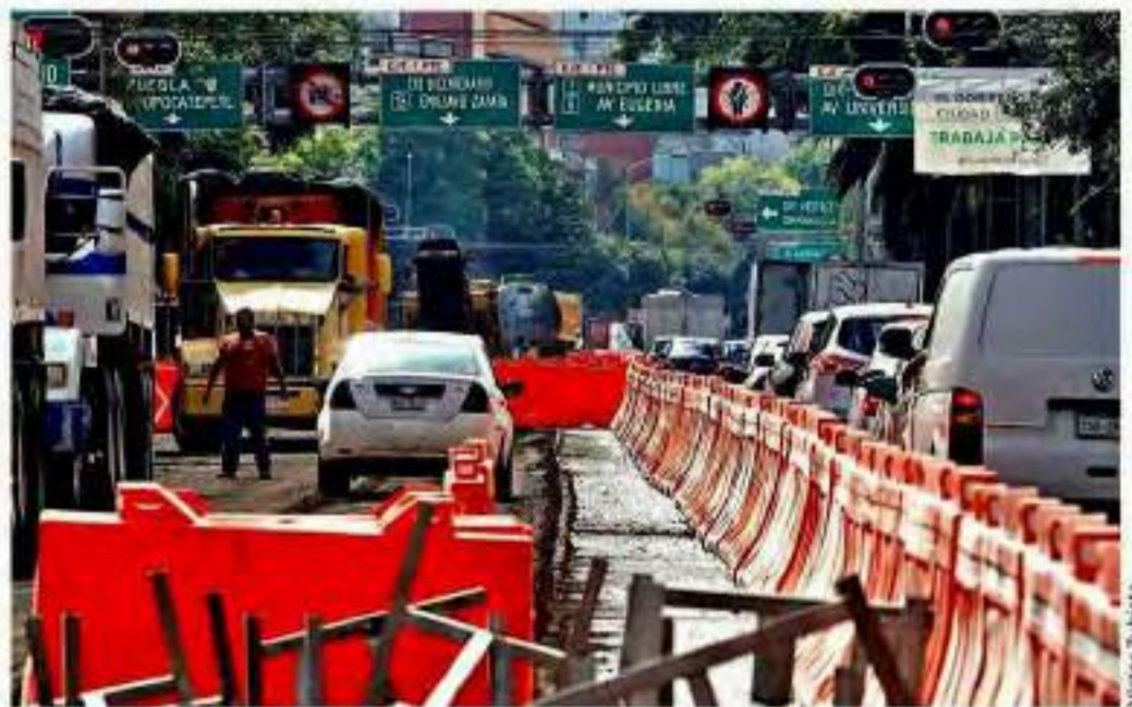
Ya fue levantado parte del pavimento para habilitar el carril exclusivo en Avenida Cuauhtémoc.
